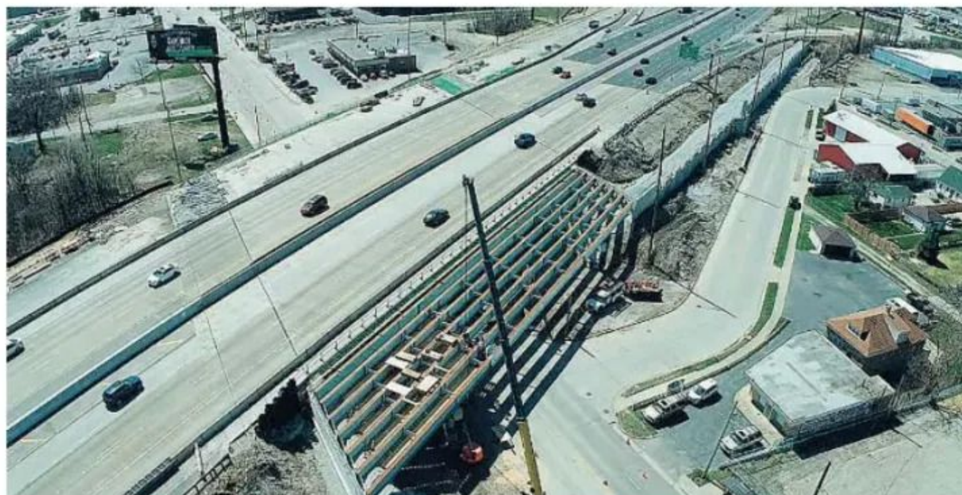
I-57 Roadway en Alsip, Illinois, una de las infraestructuras ejecutadas por la compañía en EE UU
