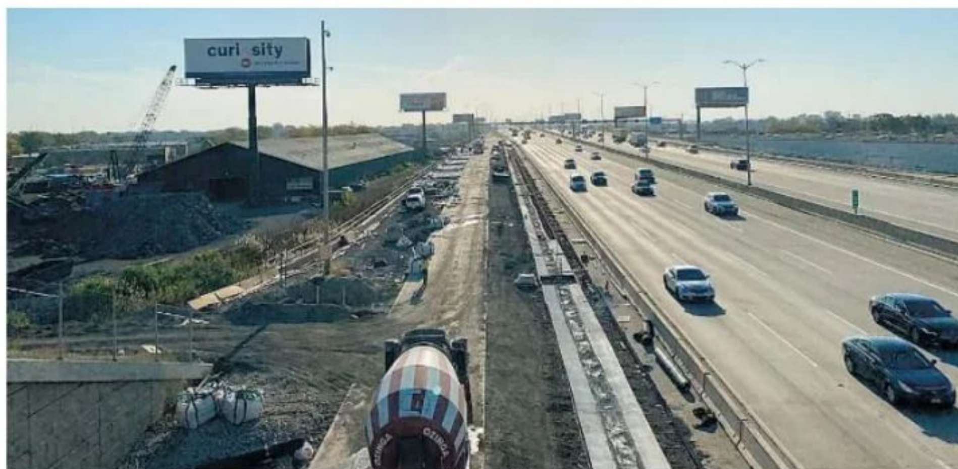
Trabajos de la filial de OHLA, Judlau, en la I-490 Elgin O'Hare Western Access de Chicago, Illinois
